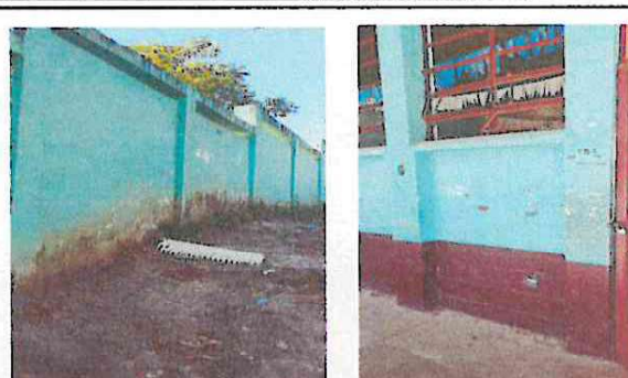
Foto 2: Paredes de la escuela y muro perimetral deteriorado
