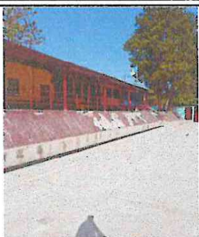
Foto 1: Parades de muro destruido
